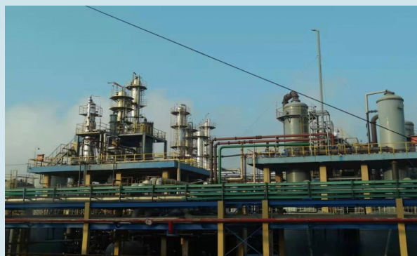
锦亿公司年产50万吨甲烷氯化物
